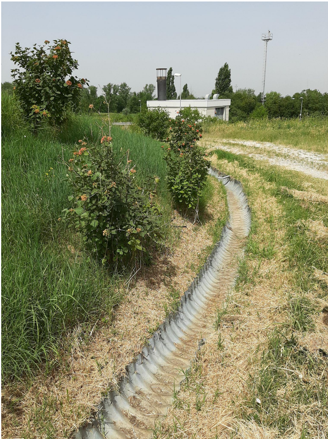
Foto 5 – canale in lamiera zincata per la raccolta acque meteoriche
