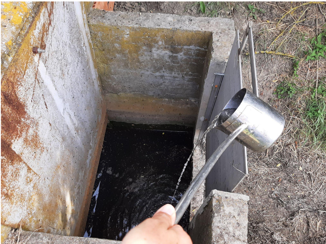
Foto 1 – acqua “residua” presente nel pozzetto a presidio dello scarico dello Scolo lato Nord della discarica di Baricella
