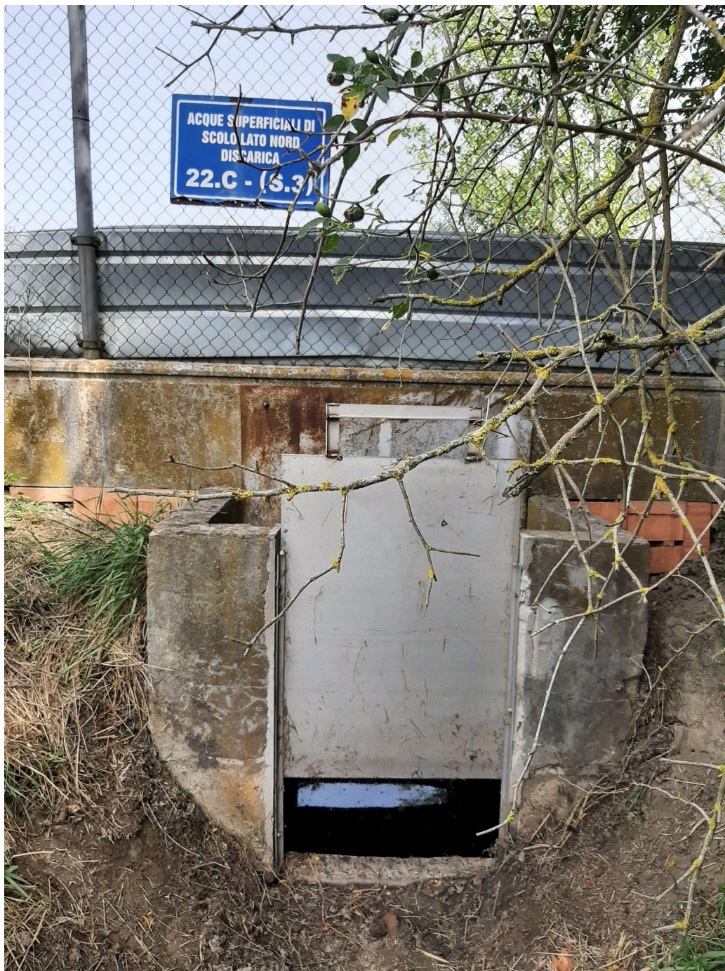
Foto 2 – pozzetto a presidio dello scarico dello Scolo lato Nord della discarica di Baricella
